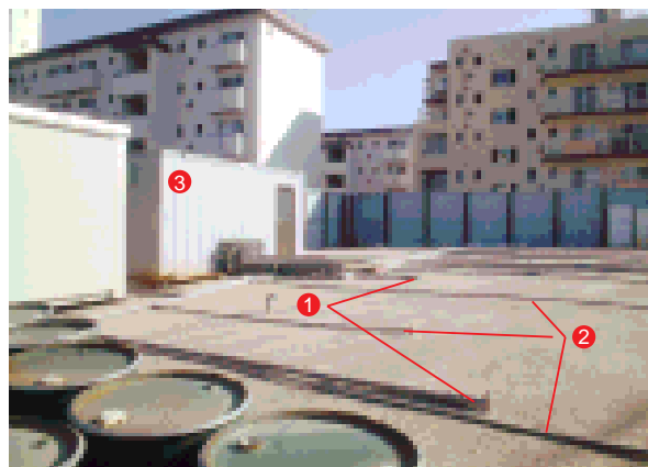
① エアースパーキング井戸 ② ガス回収井戸 ③ 処理装置
